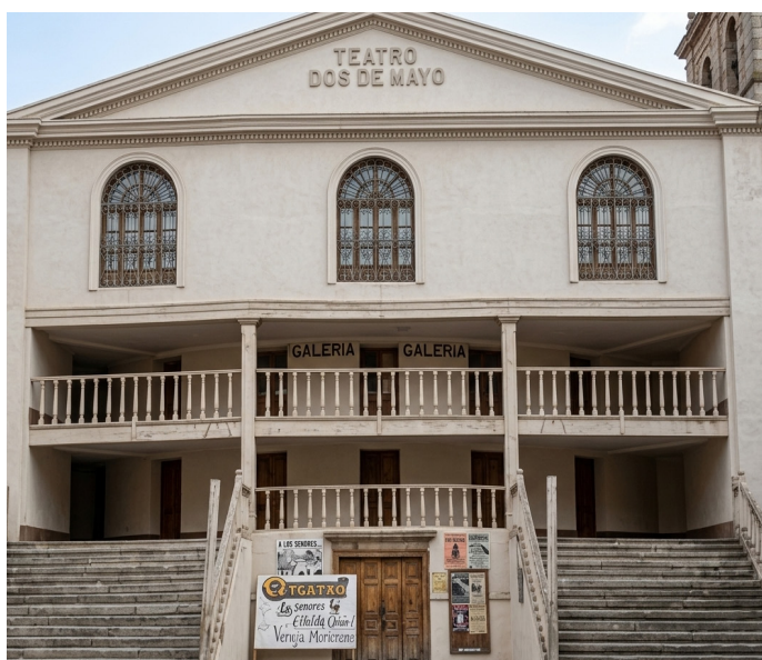
IMAGEN EL TEATRO DOS DE MAYO, DETERIORADO Y EN ESTADO DE ABANDONO
